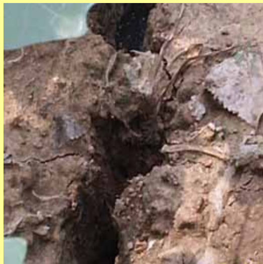
河北安平地裂缝
