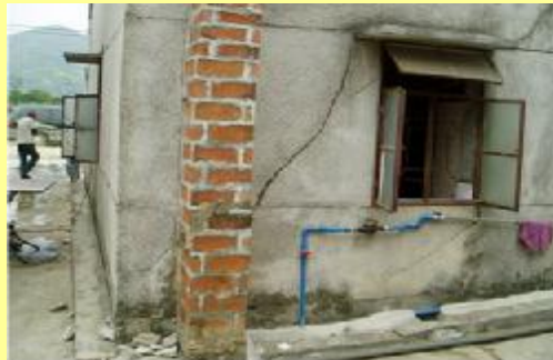
照片2 榕树吓村榕一、榕二社一巷4号（杜妹住宅）厨房东面墙体裂缝
